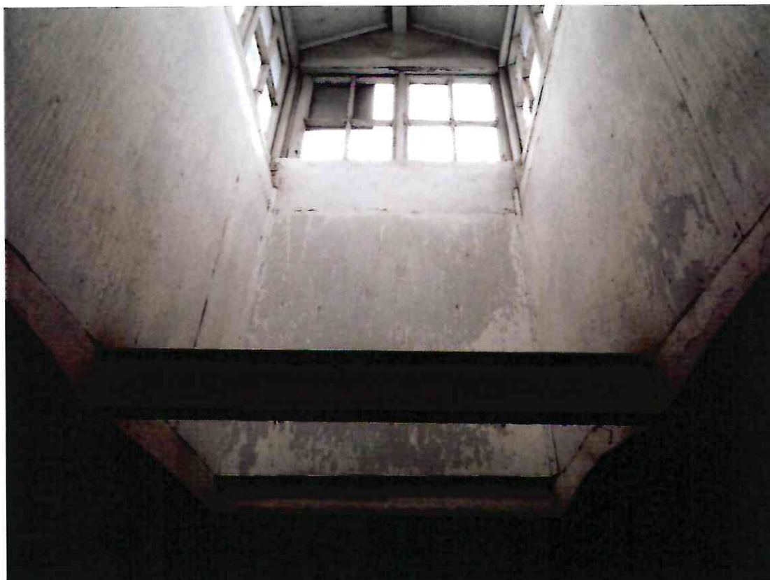
22. Световой фонарь в помещении 2-го этажа литера А, входящего в состав Объекта.
