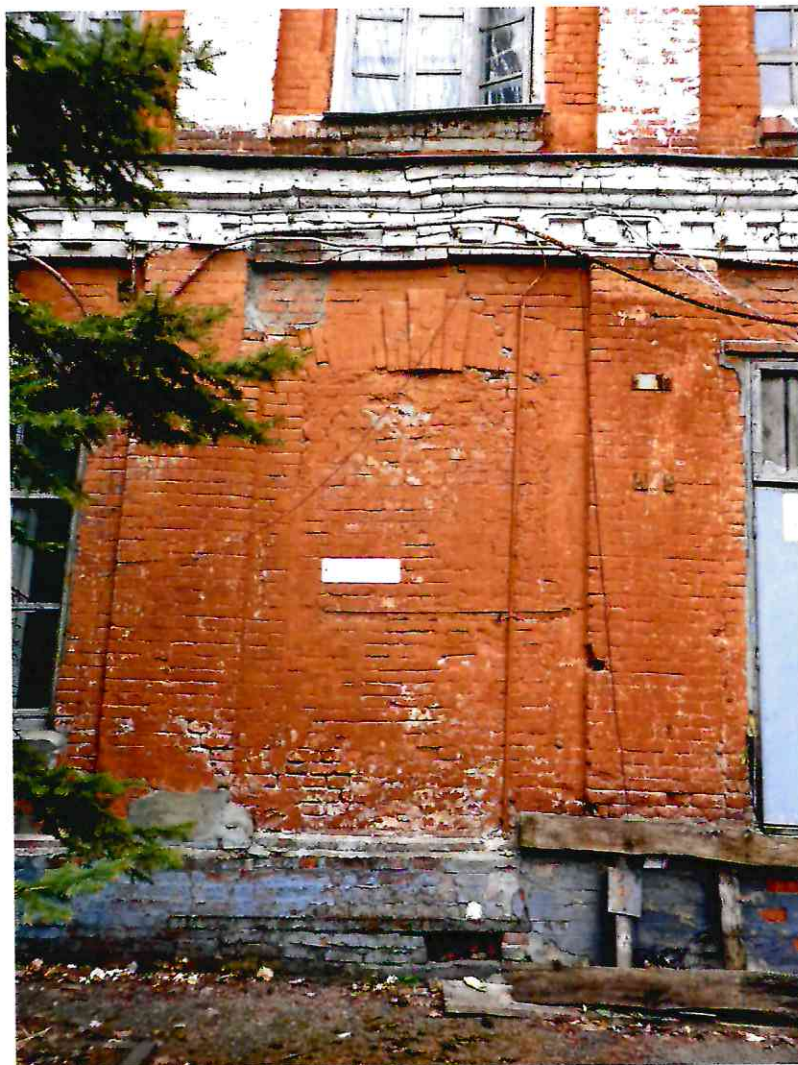
13. Поздняя закладка кирпичом оконного проема 1-го этажа восточного фасада литеры А, входящего в состав Объекта.
