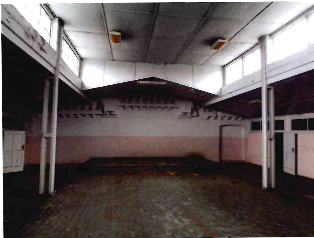
30. Помещение чердака, ленточное остекление светового фонаря литеры А, входящего в состав Объекта.
