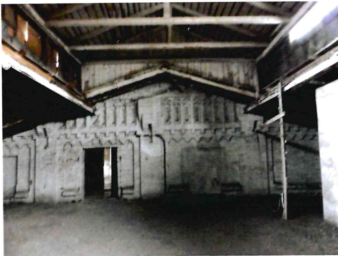
31. Помещение чердака. Кирпичный декор внутренней стены литера А, входящего в состав Объекта.
