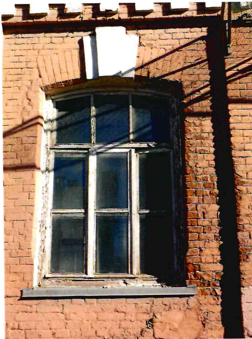
10. Следы длительного замачивания и деструкция кирпичной кладки стены западного фасада литера А, входящего в состав Объекта.
