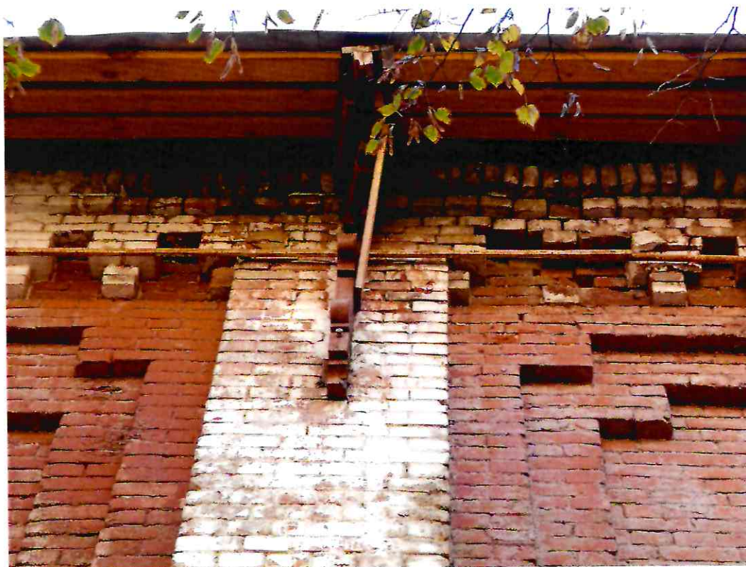
39. Трещины, разрушение кирпичной кладки венчающего карниза северного фасада литеры Ж, входящего в состав Объекта.
