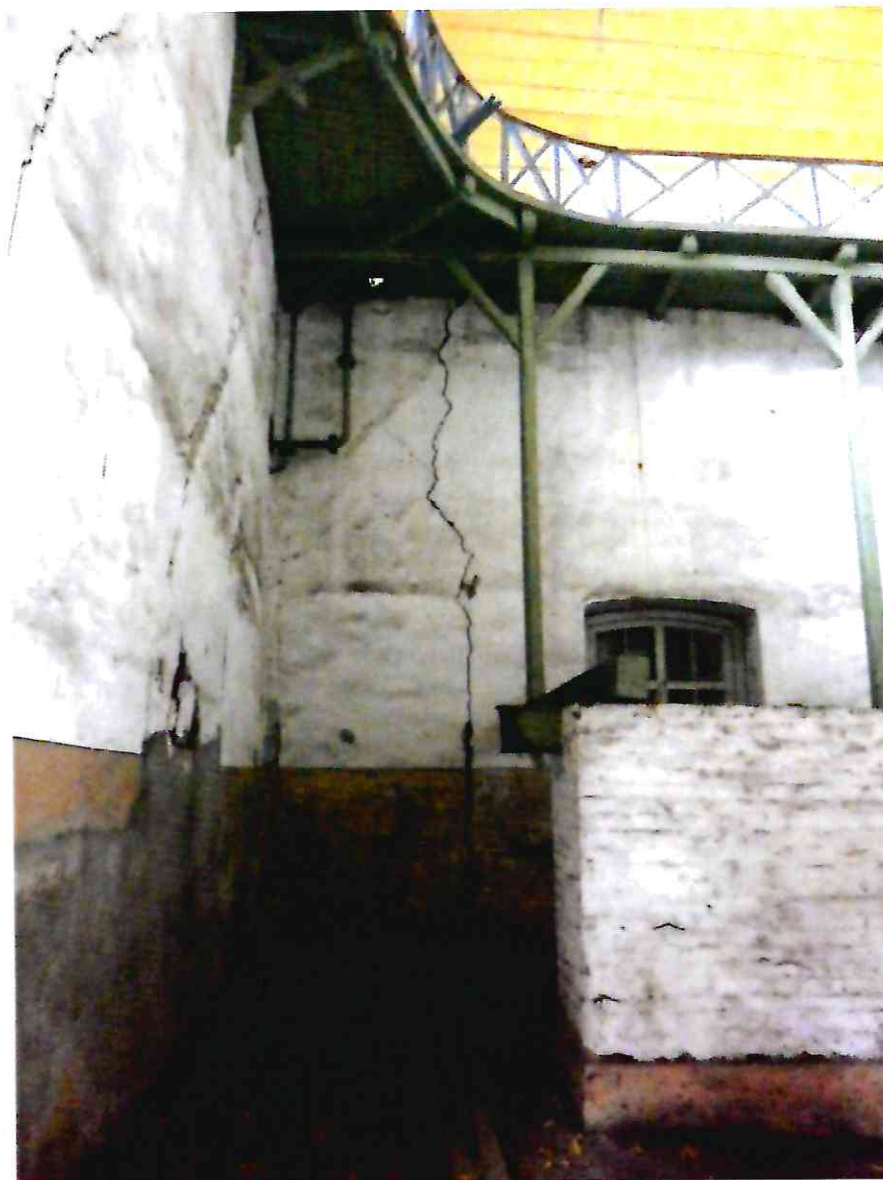
41. Помещение 1-го этажа с обходной галереей верхнего яруса. Глубокая вертикальная трещина в стене северного фасада литеры Ж, входящего в состав Объекта.
