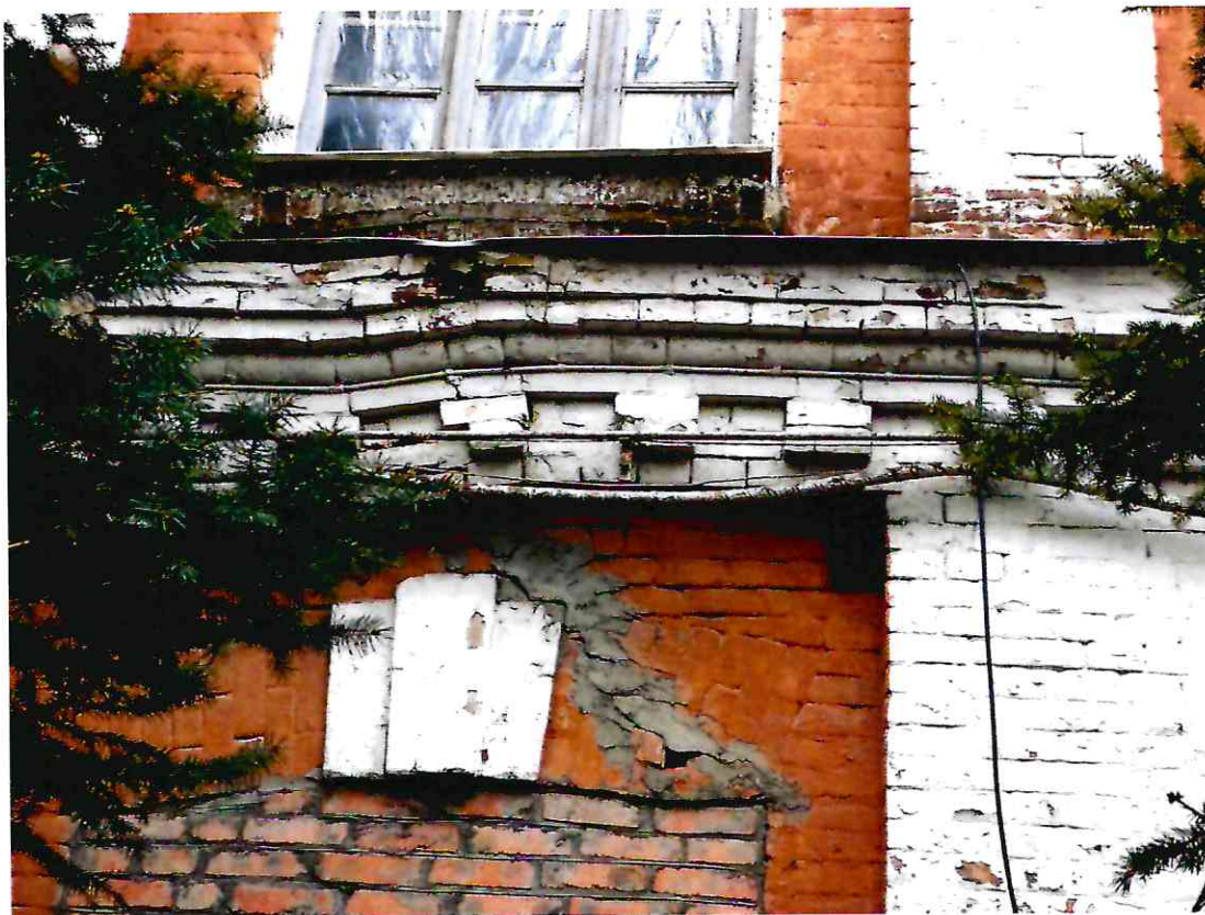
15. Глубокая диагональная трещина и искривление междуэтажного карниза восточного фасада литера А, входящего в состав Объекта.
