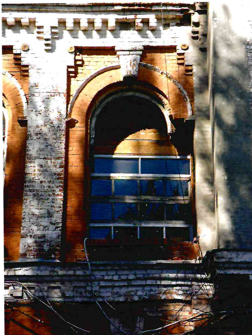
14. Разрушение откоса арочного окна 2-го этажа восточного фасада литеры А, входящего в состав Объекта.
