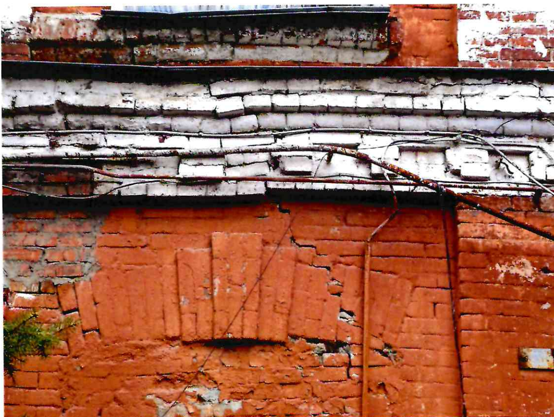
16. Диагональная трещина в перемычке окна 1-го этажа восточного фасада литера А, входящего в состав Объекта.
